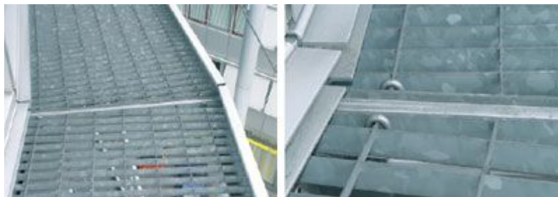
Abbildung 12: Gitterrost – gesichert durch seitliche Begrenzung und Verschraubung an der Auflage
