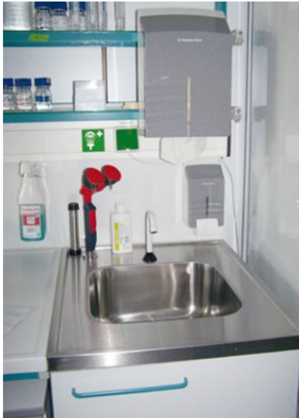
Abbildung 38: Handwaschbecken mit Sensorbedienung
