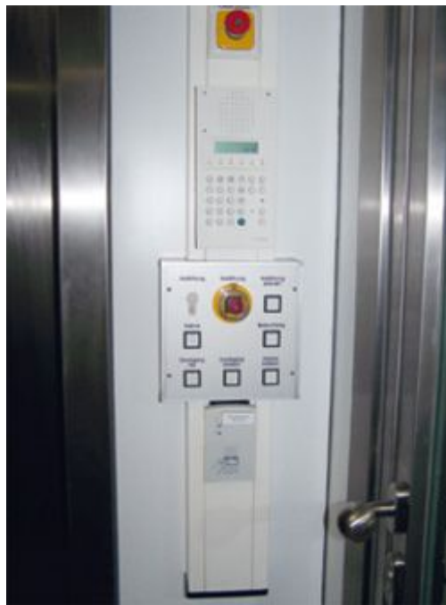
Abbildung 45: Schleusenzugang mit Wechselsprechanlage, geregelter Türfreigabe und Zugangskontrolle
