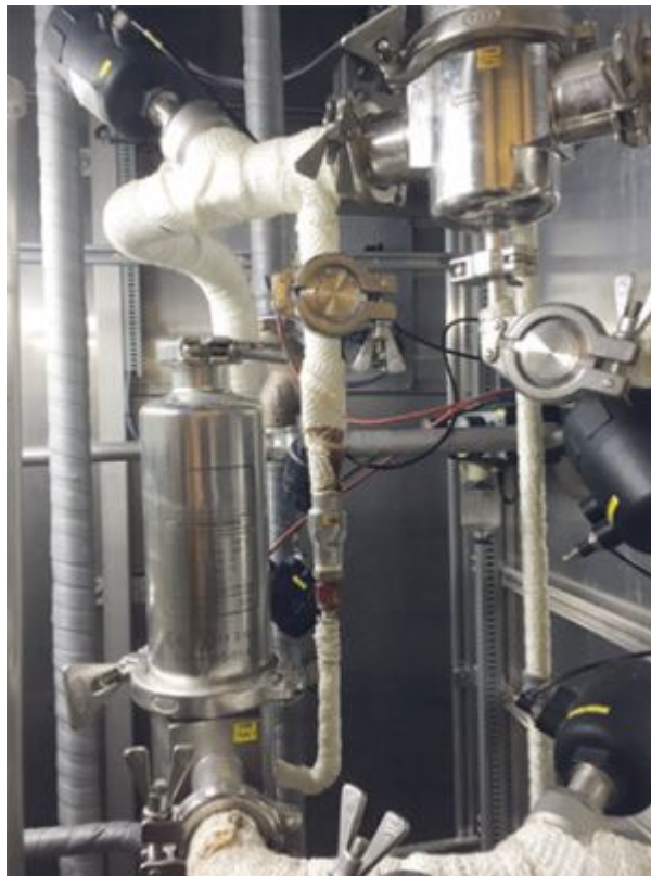
Abbildung 53: Belüftungsfilter im Technikbereich eines Autoklaven
