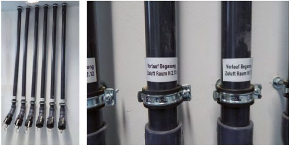
Abbildung 33: Räume im Schutzstufenbereich können einzeln zum Zwecke der Begasung mit H 2 O 2 angesteuert werden
