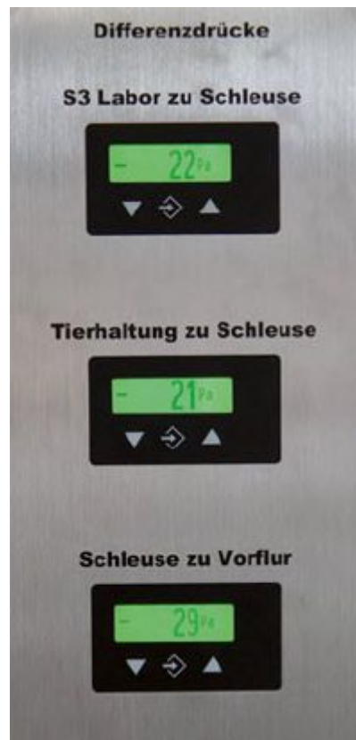
Abbildung 32: Kontrollierter Unterdruck, mit einem Alarmsystem abgesichert
