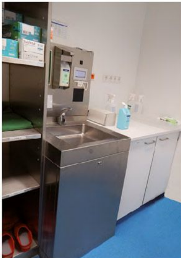
Abbildung 31: Abwassersterilisation mit gut erreichbarem Bedienpanel
