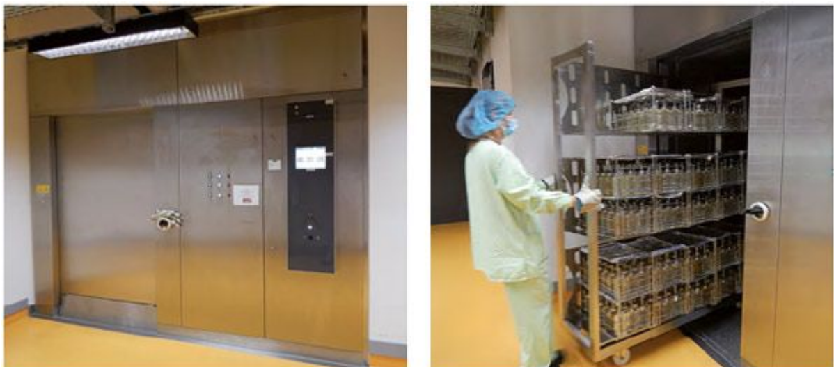
Abbildung 29: Durchreiche-Autoklav in der Schutzstufe 2
