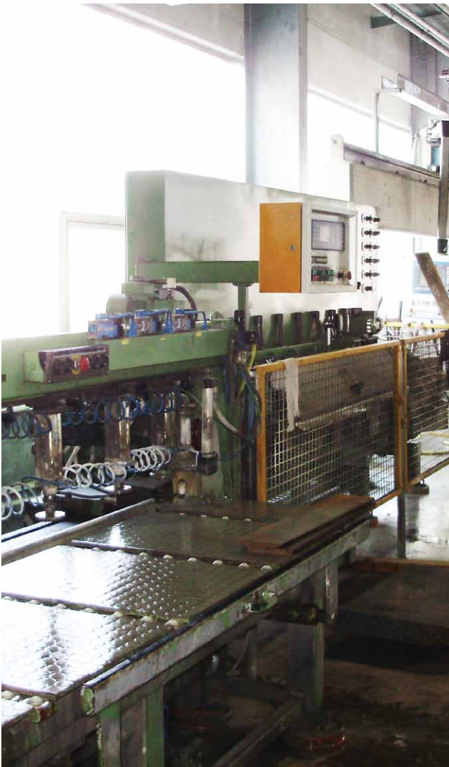
Abb. 6: Absicherung der Quetschstelle durch ein fest angebrachtes Gitter
