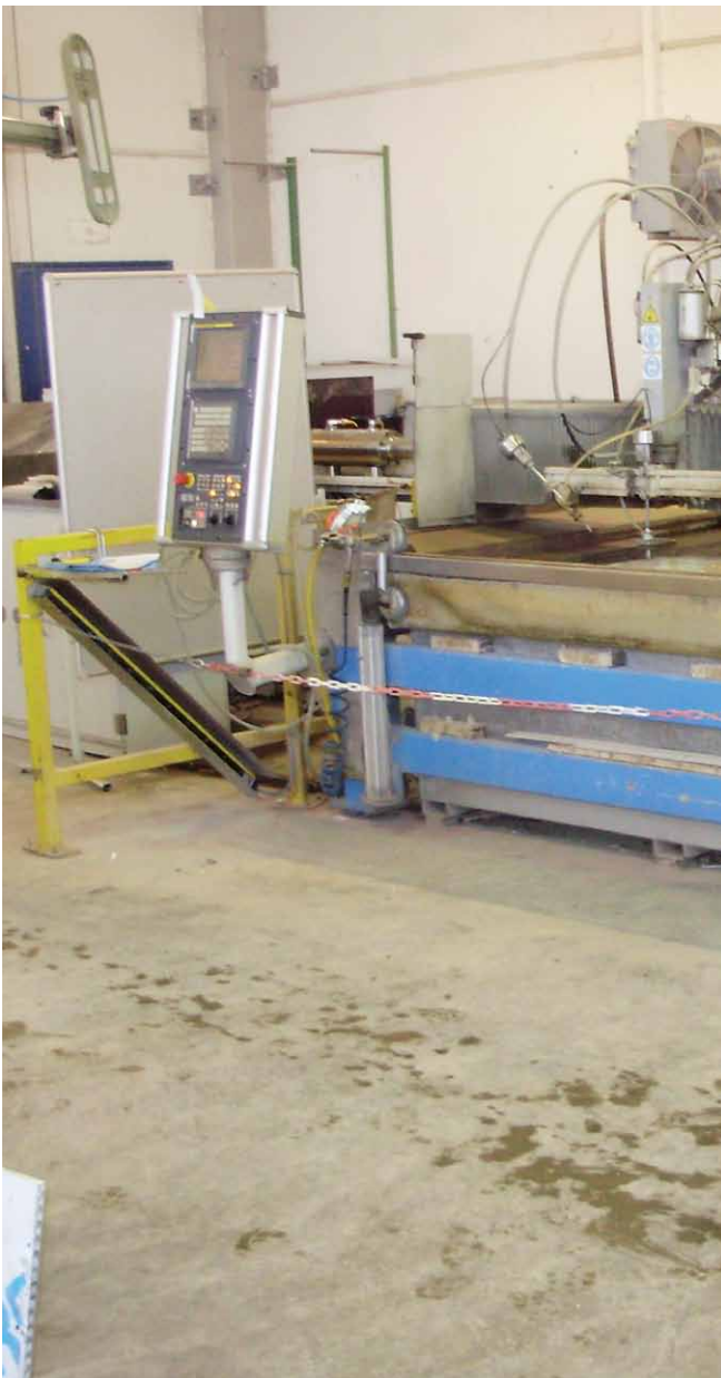
Abb. 8: Absicherung des Gefahrenbereiches durch Lichtschranke, die rot-weiße Kette soll das unbeabsichtigte Auslösen der Lichtschranke verhindern
