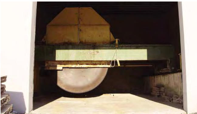
Abb. 15: Nur eine Anlage (Blocksäge) in der Halle
