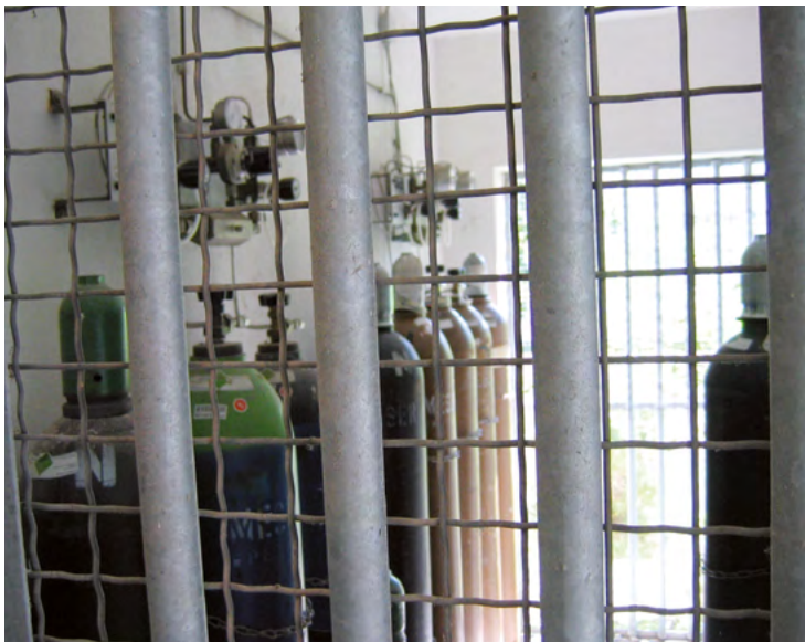
Abbildung 17: Gasentspannungsstation für Laborgase außerhalb des Laborraumes in einem gut gelüfteten Sonderraum
