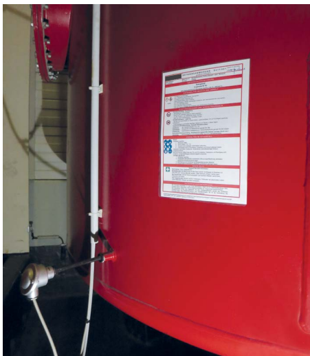
Abbildung 14: Betriebsanweisung an einem Isocyanat-Tank
