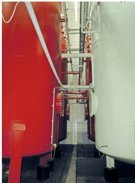
Abbildung 10: Unterschiedliche farbliche Kennzeichnung Isocyanat-Tank und Polyol-Tank
