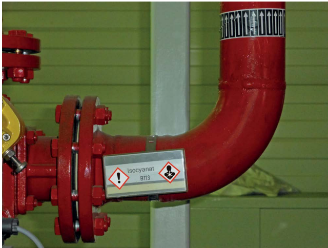
Abbildung 15: Kennzeichnung Isocyanat-Leitung mit Angabe der Durchflussrichtung
