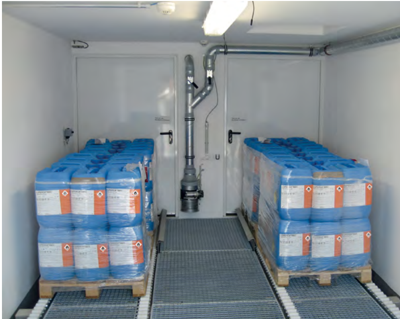
Abbildung 2: Innenansicht der Peroxid-Lagerbox
