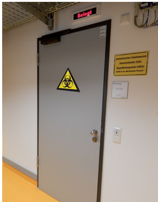
Abbildung 28: Zugang zur Schleuse mit automatischer Belegungs-Anzeige und Kennzeichnung Schutz- stufenbereich 2
