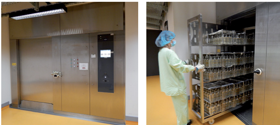
Abbildung 29: Durchreiche-Autoklav in der Schutzstufe 2
