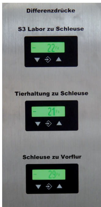
Abbildung 32: Kontrollierter Unterdruck, mit einem Alarmsystem abgesichert
