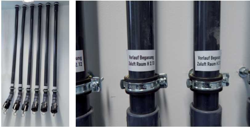
Abbildung 33: Räume im Schutzstufenbereich können einzeln zum Zwecke der Begasung mit H 2 O 2 angesteuert werden
