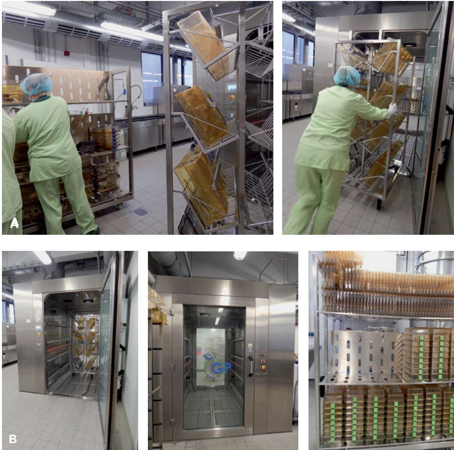
Abbildung 21: Aufbereitung in der Spülküche: A schmutzige Seite mit Beschickung der Reinigungsanlage mit bodeneben befahrbare Geräten, B saubere Seite mit Ansicht auf die Reinigungsanlage und Transportwagen mit leeren Käfigen
