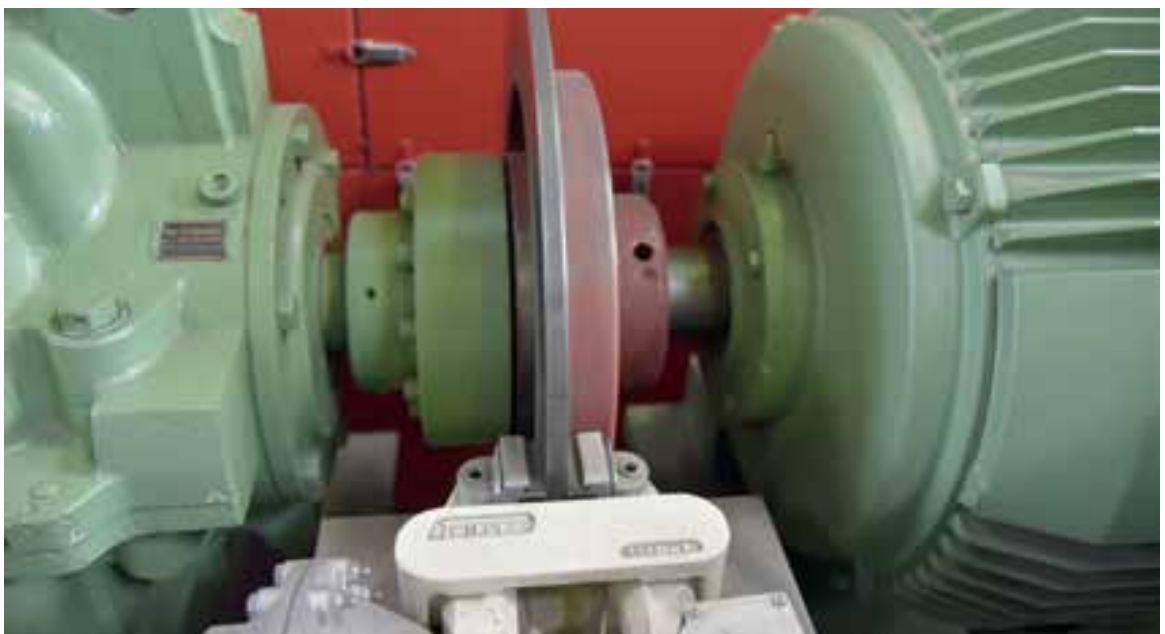
Abbildung 17: Nachrüstung einer Walzwerksbremse an der Motorkupplung
