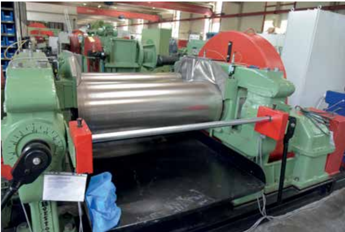
Abbildung 7: Nachgerüstetes Gummiwalzwerk mit Schaltstange
