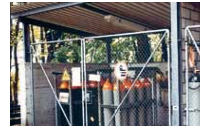
Der Lagerplatz darf für Unberechtigte nicht zugänglich sein
