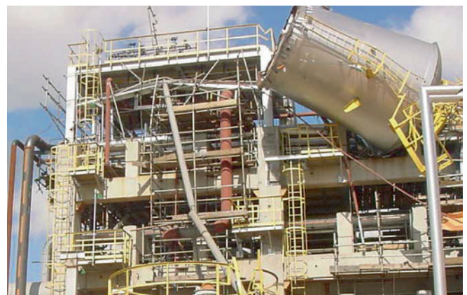
Abbildung 1: Abheben eines Tanks infolge Überdrucks
