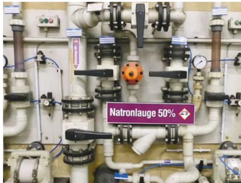
Abbildung 19: Kennzeichnung von Rohrleitungen
