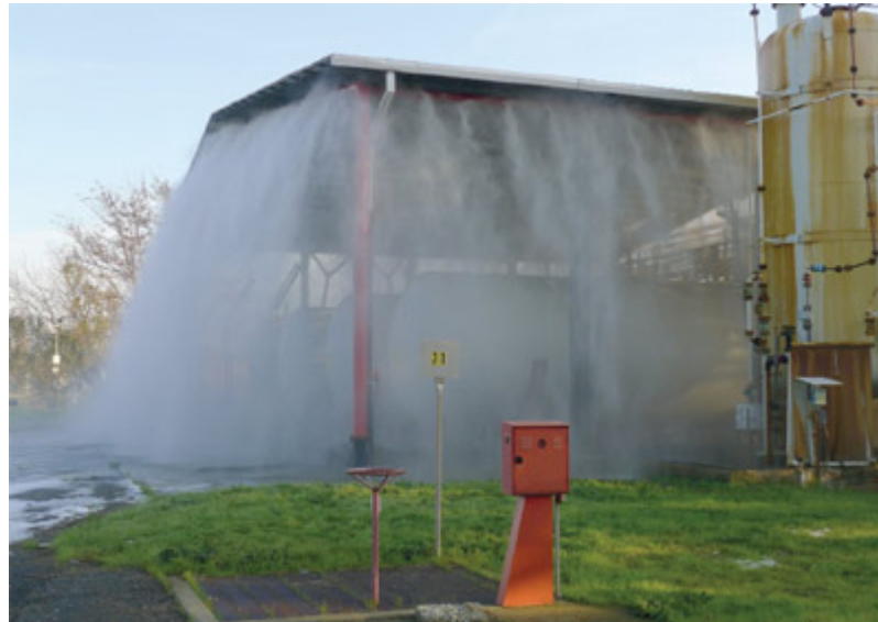
Abbildung 5: Fest installierter Wasservorhang
