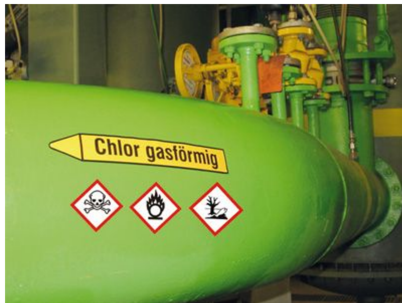
Abbildung 12: Kennzeichnung einer chlorführenden Rohrleitung
