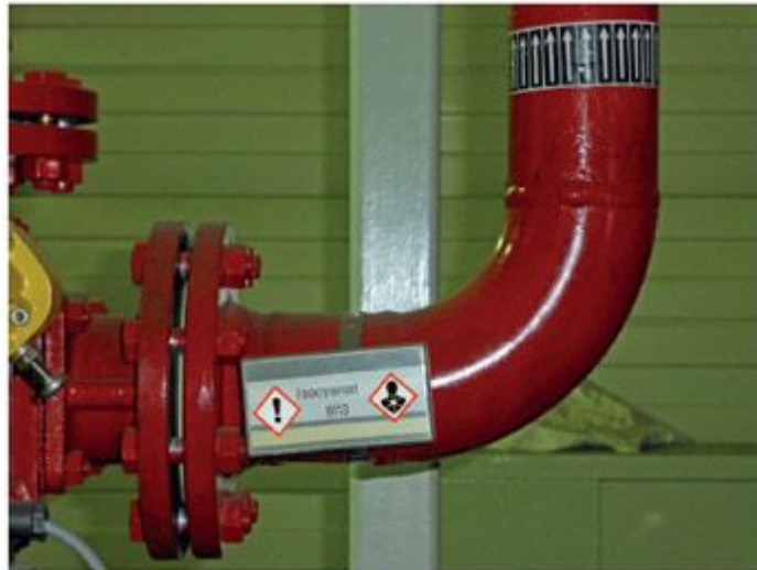
Abbildung 15: Kennzeichnung Isocyanat-Leitung mit Angabe der Durchflussrichtung
