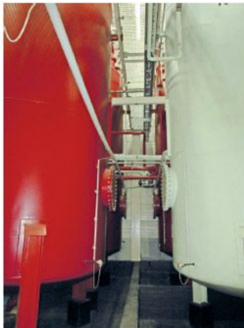
Abbildung 10: Unterschiedliche farbliche Kennzeichnung Isocyanat- Tank und Polyol-Tank
