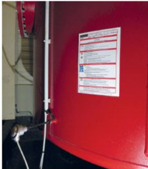
Abbildung 14: Betriebsanweisung an einem Isocyanat-Tank
