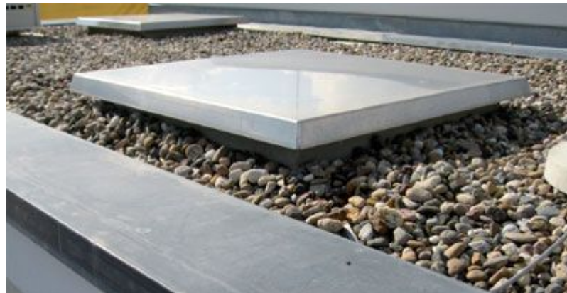
Abbildung 3: Druckentlastungsfläche im Dach der Lagerbox von außen gesehen
