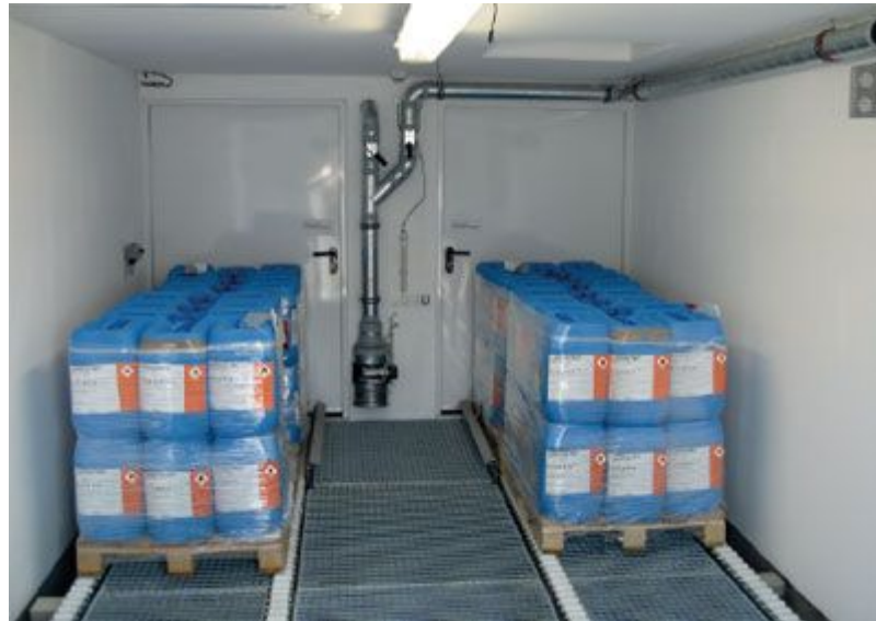
Abbildung 2: Innenansicht der Peroxid-Lagerbox
