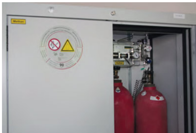
Abbildung 12: Angeschlossene Druckgasflaschen in einem Sicherheitsschrank für Gase
