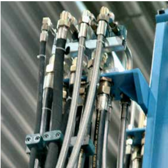
Abbildung 23: Zusätzliche Befestigung von Hydraulikschlauchleitungen, um Herumschlagen zu vermeiden
