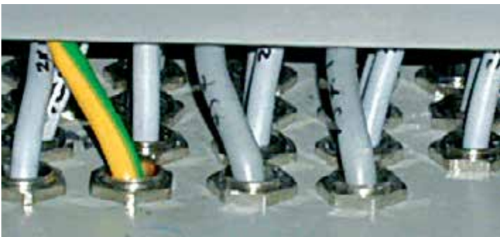
Abbildung 29: Dichte Kabeleinführung mittels PG-Verschraubung
