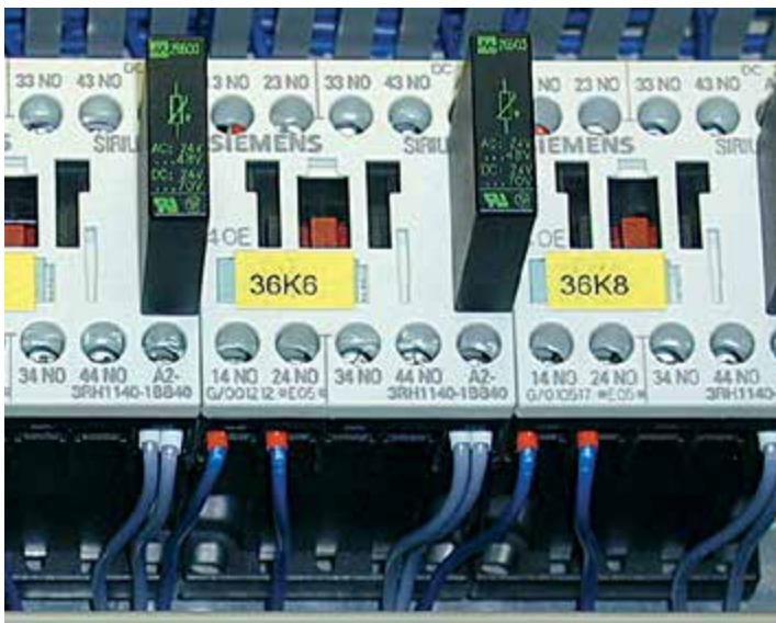
Abbildung 27: Verhinderung gefährlicher Berührspannungen durch versenkt angeordnete Anschlussklemmen (fingersichere Ausführung) an Hilfsschützen innerhalb eines Schaltschranks, Kennzeichnung aller elektrischer Betriebsmittel in Übereinstimmung mit den Schaltplänen
