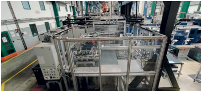
Abbildung 53: Schutzeinrichtung für Peripheriegeräte im Arbeitsumfeld der Spritzgießmaschine
