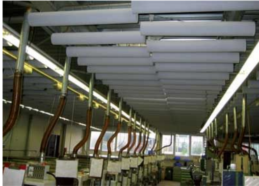
Abbildung 26: Hallendecke mit Rundabsorberrn
