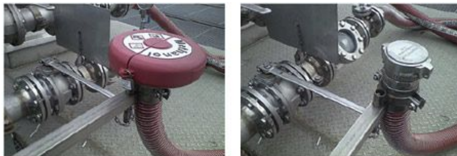
Abbildung 32: Mit einem Vorhängeschloss gesichertes Verriegelungssystem an der Belade-/Entladeanlage (links)
