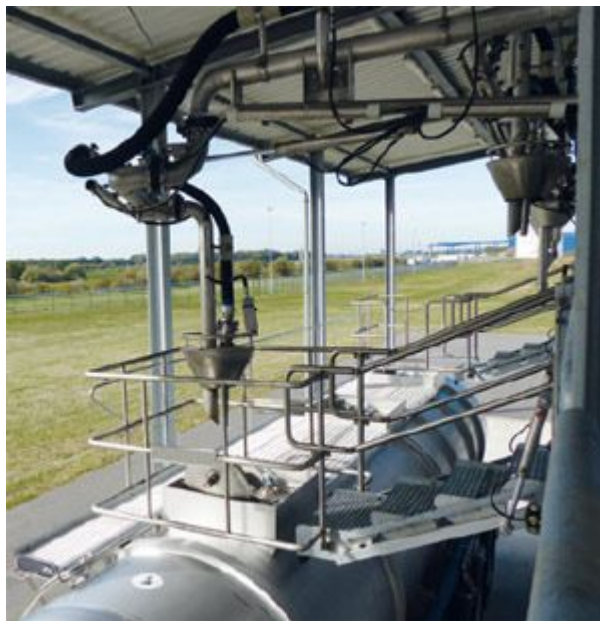
Abbildung 35: Befüllen über Dom: Doppelgelenkarm mit Gaspendelleitung
