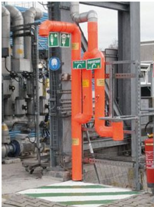
Abbildung 42: Auffällig gestaltete begleitbeheizte Körpernotdusche mit angeschlossener Augennotdusche
