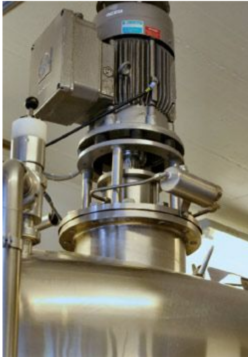
Abbildung 10: Die Ausdehnung des explosionsgefährdeten Bereiches außerhalb des Behälters hängt von der Technologie der Wellenabdichtung ab
