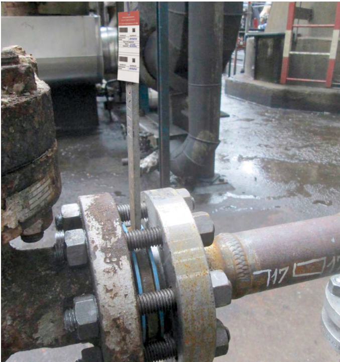
Abbildung 24: Eingebaute Steckscheibe mit Dichtungen
