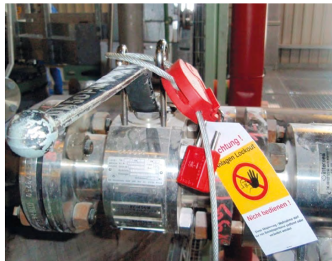
Abbildung 17: Beispielhafte Markierung einer Trennstelle an einem Kugelhahn
