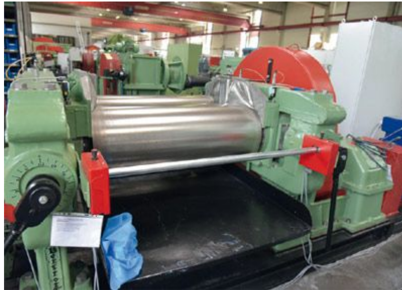
Abbildung 7: Nachgerüstetes Gummiwalzwerk mit Schaltstange
