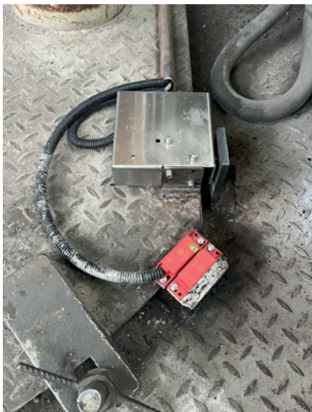
Abbildung 6: Zuhaltung als Kombination aus Bauart-4-Näherungsschalter und elektromechanischem Bolzen
