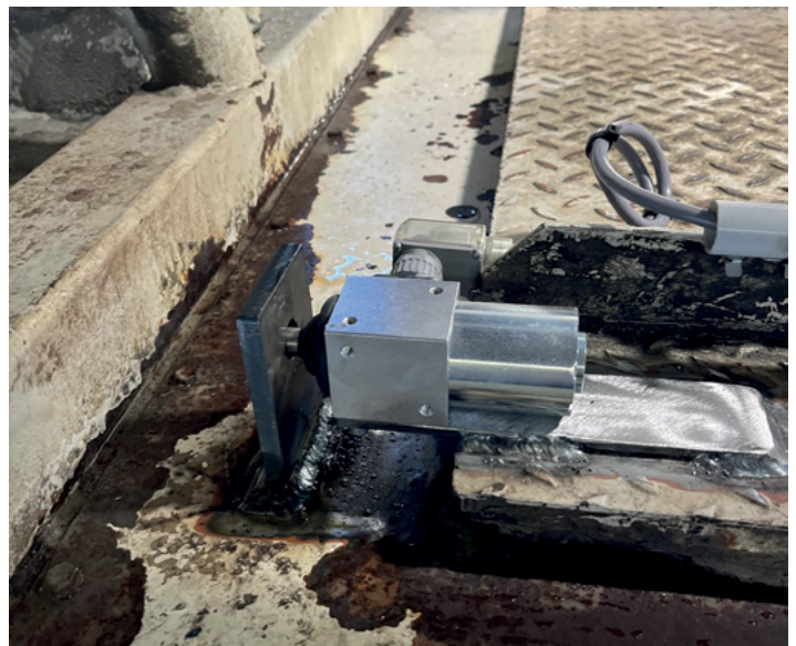
Abbildung 7: Elektromechanischer Bolzen am Mischerdeckel
