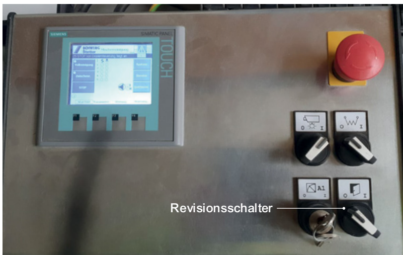
Abbildung 11: Revisionschalter im Steuerraum zur Anforderung der Schlüsselfreigabe
