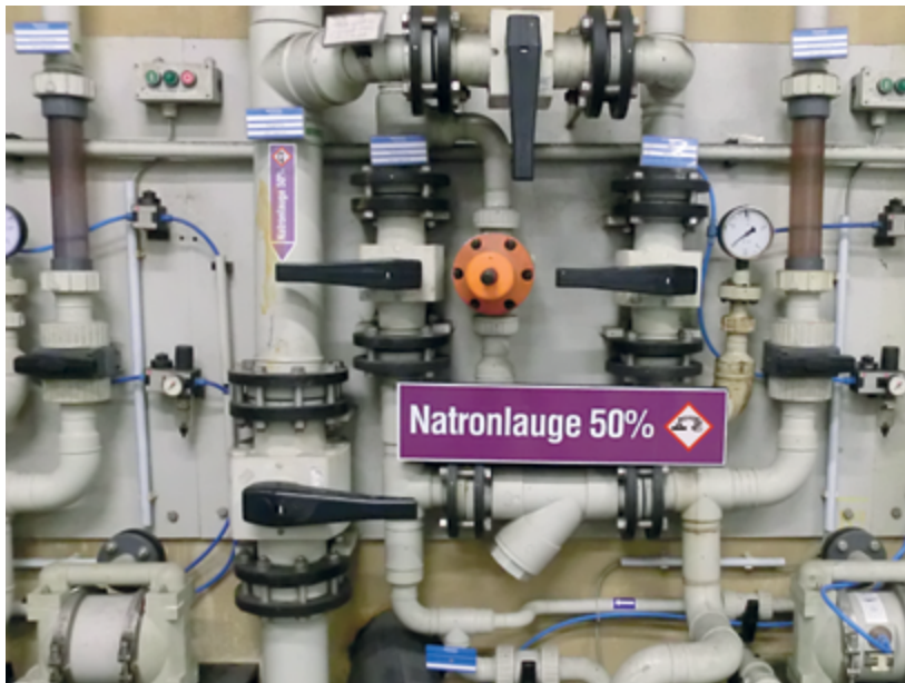
Abbildung 19: Kennzeichnung von Rohrleitungen
